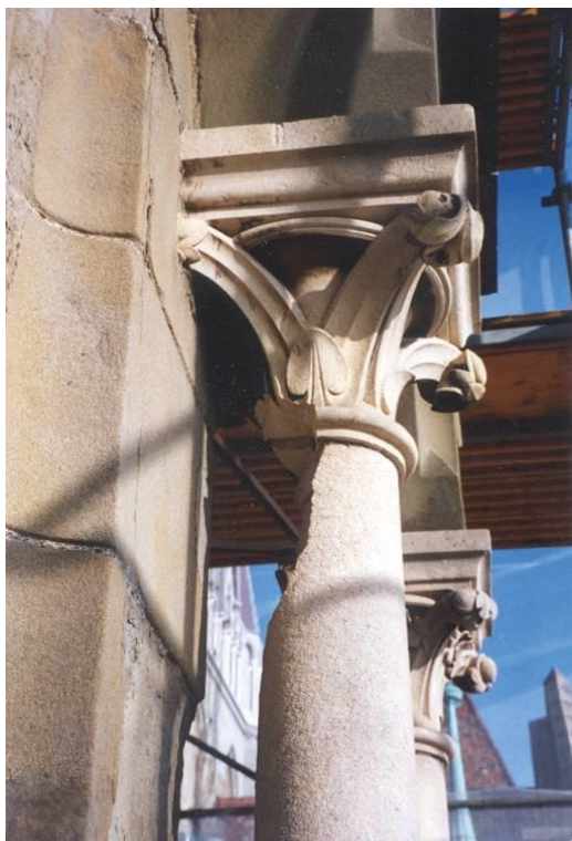
Dégâts typiques dus à la rouille d'éléments métalliques
