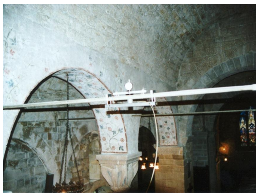
Mesure de la tension dans les anciens tirants de la Nef
