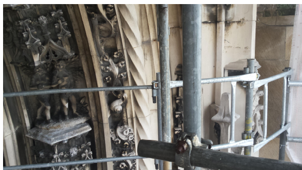
Échafaudage permettant l'accès aux parties hautes du Portail pour l'analyse des mouvements de
