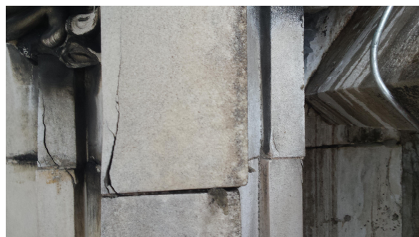
Glissement observé à la base Sud de l'arc du portail
